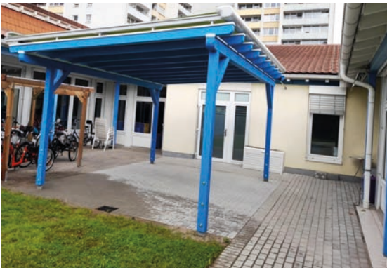
Mit Hilfe des Förderkreises konnte die Terrasse der Tagesförderstätte barrierefrei und mit Wetterschutz gestaltet werden.
